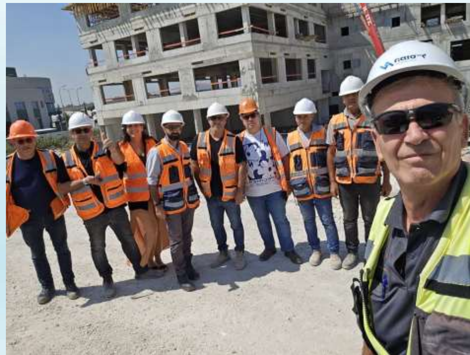
אבחון באתר בנייה חברת י.לרר הנדסה – סיור וועדת בטיחות באתר א. תעשייה מבוא כרמל
