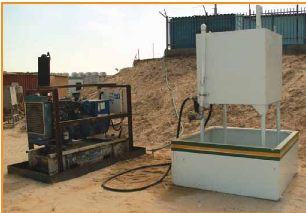
תמונה 1: גנרטור ארעי המיועד לאספקת חשמל סדירה ומיכל הדלק שלו
